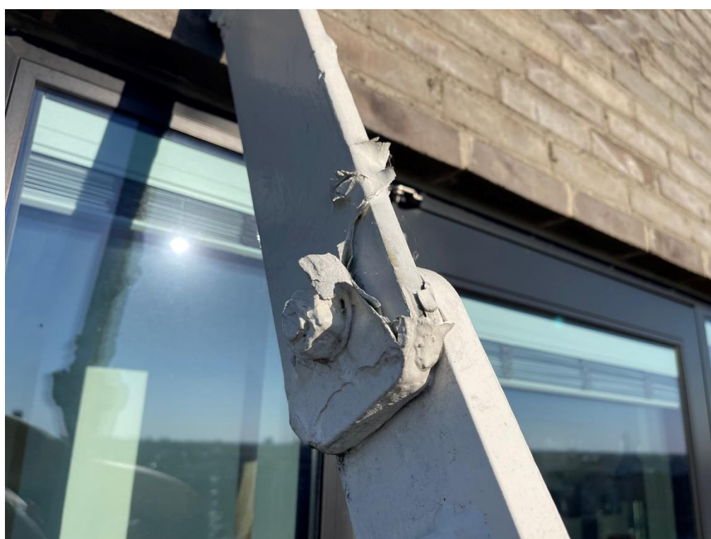
Fig 1 og 2. tilsendt foto af afskallet maling på Skråstag.
